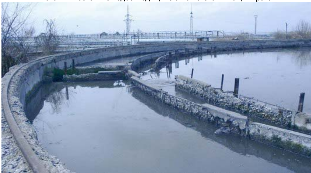
Фото 4.4. Состояние водоотводящих лотков отстойников, г. Ереван
