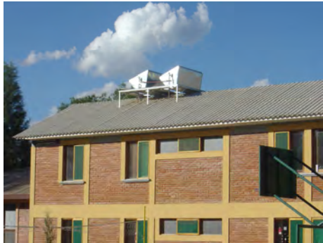
Quelques uns des chauffe-eau solaires installés.
